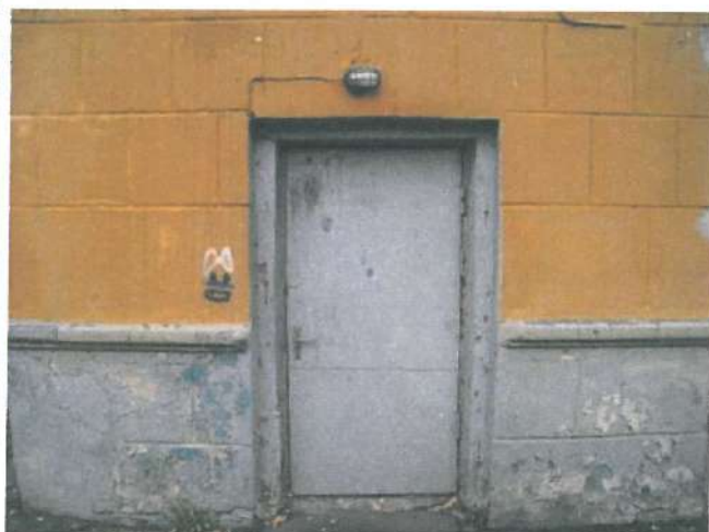
4.13.4. att. Novecojušas koka konstrukcijas ārdurvis ar skārda apdari
