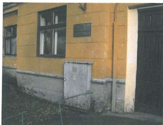
6.2. att. Elektrības sadales skapis pie galvenās ieejas
