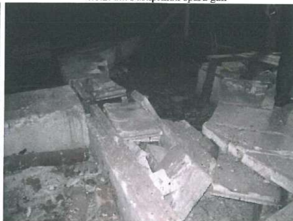
4.8.4. att. Pussabrukušī ventilācijas kanāli
