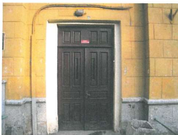
4.13.5. att. Bojātas/novecojušas centrālās ieejas ārdurvis
