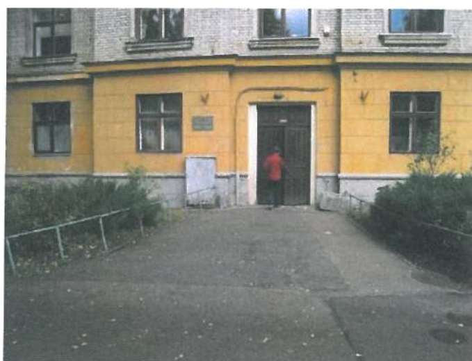
3.1.3. att. Nelīdzens asfaltbetona segums pie galvenās ieejas
